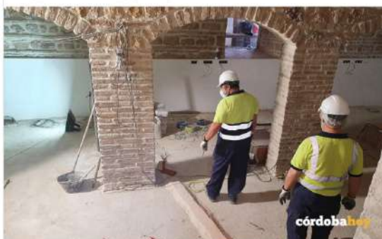
Obras de la zona de hostelería del Palacio de Congresos de la calle Torrijos
